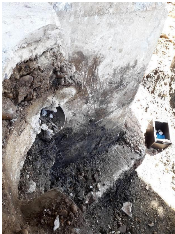
Fondation souillée par des hydrocarbures
