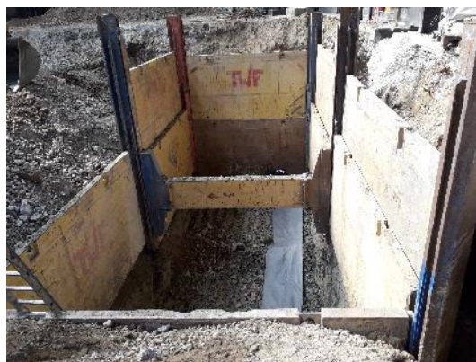
Passe 1 – vue du blindage provisoire et mise en place de géotextile en fonds de fouille
